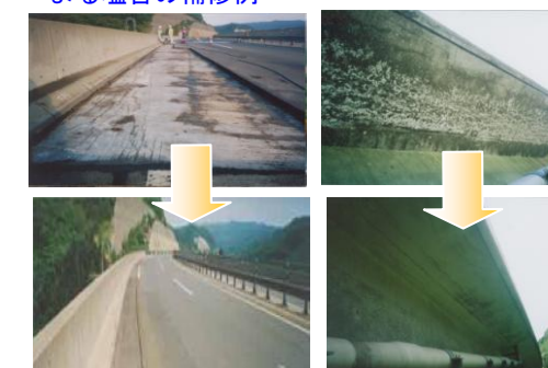
ひび割れた床版に対する凍結防止剤散布による塩害の補修例
